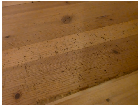
Slitasje utover normal slitasjegrad
