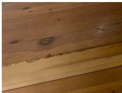
Skader i trappetrinn
