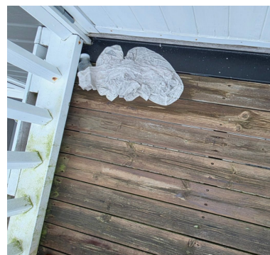
Det er værslitt/oppsprukket trevirke/trepaneler.
