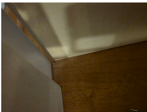
Dørblad tar i terskel
