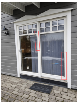
Balkongskyvedør er vanskelig å betjene. Det er løse glasslister
