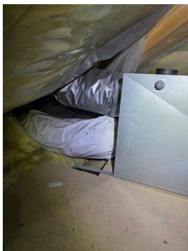
Mangelfull isolering og brudd på dampsperre.
