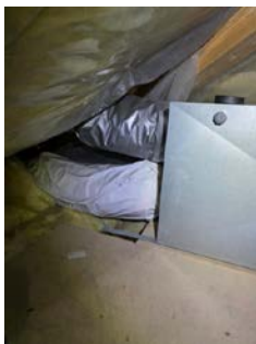
Mangelfull isolering og brudd på dampspærre.
