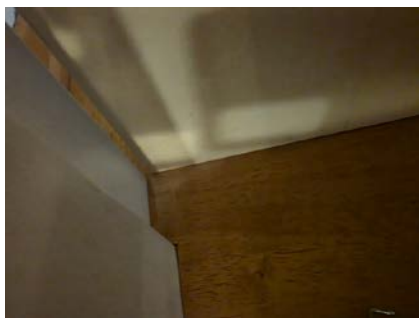
Dørblad tar i terskel
