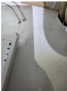
Fuktskader på bunnplate i skrog under vask
