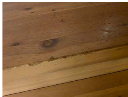
Skader i trappetrinn
