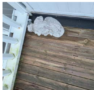
Det er værslitt/oppsprukket trevirke/trepaneler.
