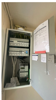
Sikringsskap med automatsikringer.
