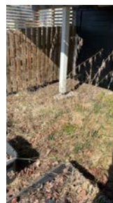
Enkelt fundamentering på leca-klosser direkte på grunn uten synlig markisolasjon. Dette kan føre til at konstruksjon løftes av frost.
