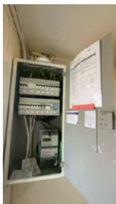
Sikringsskap med automatsikringer.
