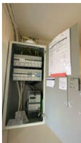
Sikringsskap med automatsikringer.
