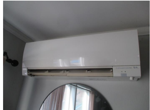
Varmepumpe i stue.
