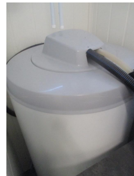
Bereder er plassert på vaskerommet.
