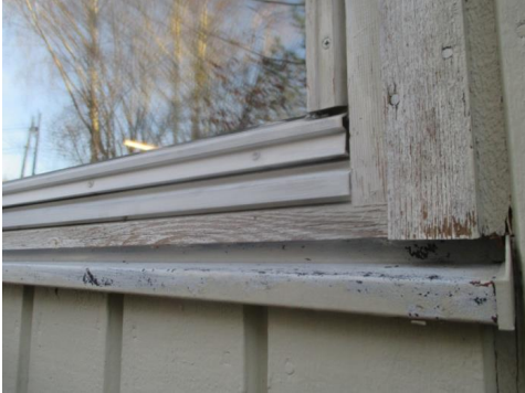
En del slitasje på utvendig karm og ramme.
