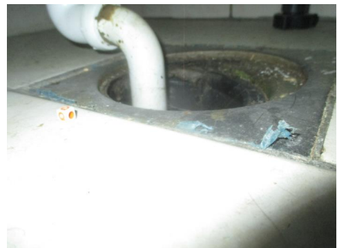
Sluk under badekar og det er ingen fall på gulvet.
