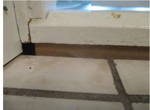
Ingen fuktsikring i mot dør.
