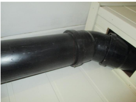
Avløpsrør av plast.
