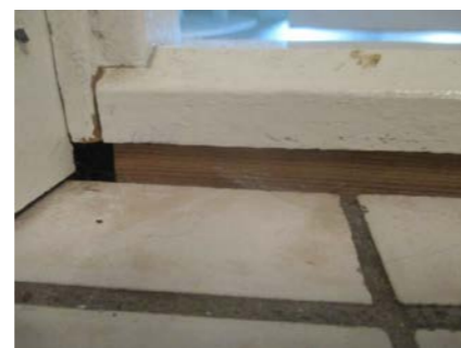
Ingen fuksikring i mot dør.
