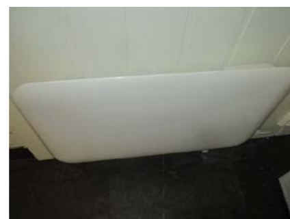
Panelovn på veggen.
