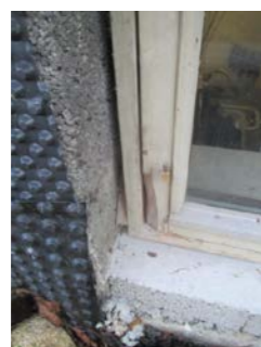
Skade på vindu til vaskerom som må pusses inn utvendig.
