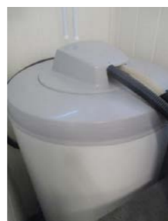
Bereder er plassert på vaskerommet.
