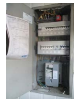
Sikringsskapet er plassert i vindfang.
