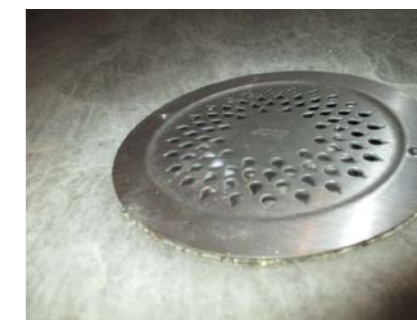
Sluk under innredning.
