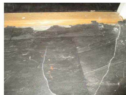
Større skader på gulvbelegget i område nær dør.
