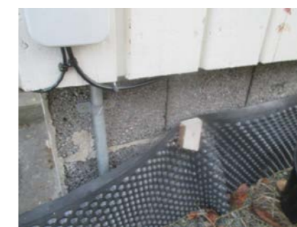
Grunnmur må pusses på ene hjørne over terreng.
