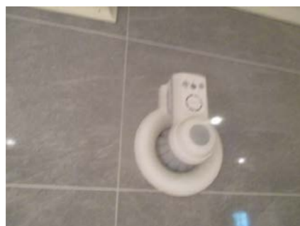
Vifte i ytterveggen.
