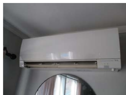
Varmepumpe i stue.
