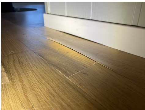
Svelleskade på parkett ved kjøkkenvegg.
