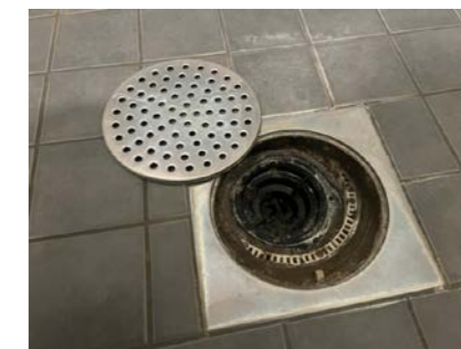
Sluk i dusjsone.
