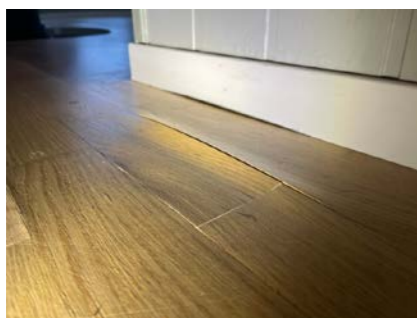
Svelleskade på parkett ved kjøkkenvegg.
