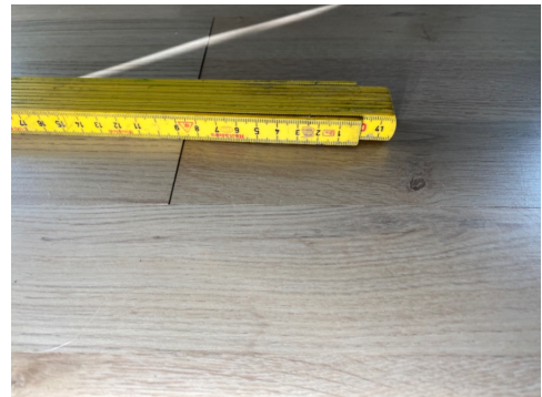
Glippe i skjøte laminatgulv på stuen.
