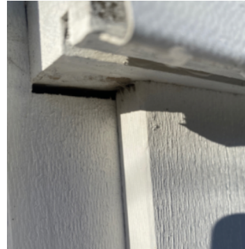
Stedvis glipper mellom kledning og vinduer.
