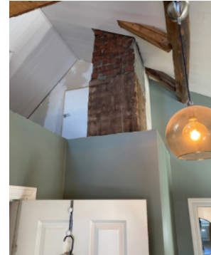
Deler av pipevanger er ikke synlige.
