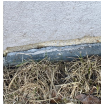
Ingen synlig fuktsikring mot mur
