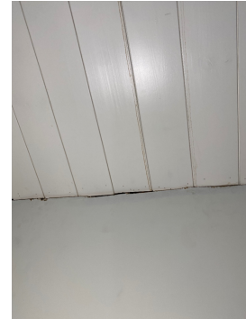
Rennemerker fra pipen og langs takpanel i loftsstuen.
