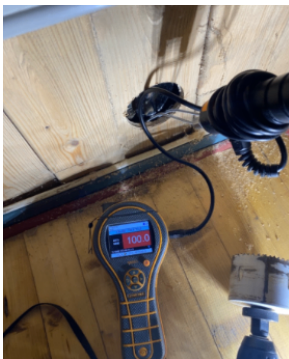
Fuktmåling i innforet vegg mot sørpst.
