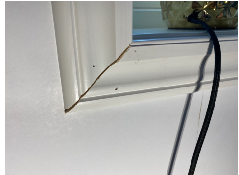
Glippe i sammenføring listverk rundt vindu
