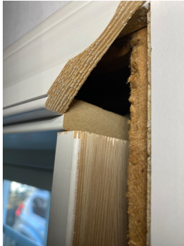
Manglende isolering/dampsperre rundt innforet vindu mot nord.
