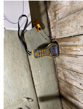
Fuktmåling mot panelet, skillevegg på bod.
