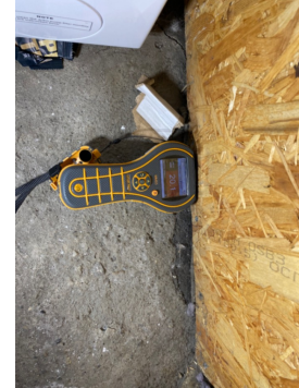
Fuktmåling mot veggplate mot trappenedgang.
