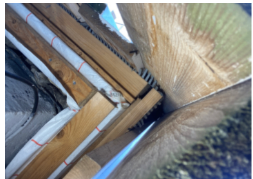
Tetting med musebånd må utbedres.
