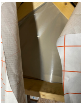
Delvis manglende dampsperre mot vegg
