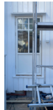
Balkongdør mot øst mangler utvendig trapp.
