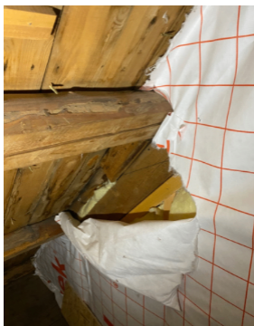
Manglende klemming/tetting av vindsperre mot kald sone.
