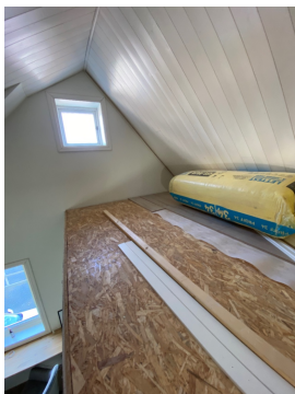
Det må etableres rekkverk på hems.
