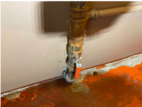
Stoppekrane. Irr og rust mot vannledning.
