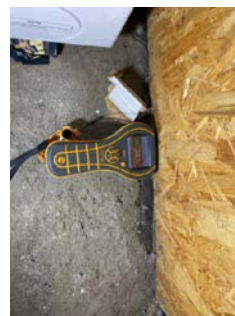
Fuktmåling mot veggplate mot trappenedgang.
