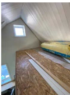
Det må etableres rekkeverk på hems.
