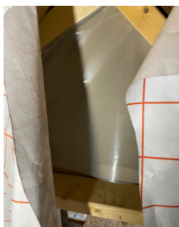
Delvis manglende dampsperre mot vegg
