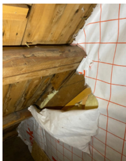
Manglende klemming/tetting av vindsperre mot kald sone.
