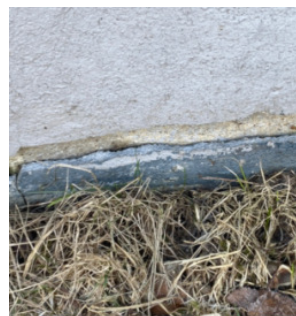
Ingen synlig fuktsikring mot mur
