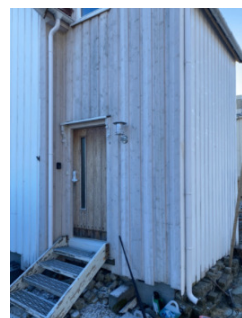
Grunnet kledning på deler av huset
