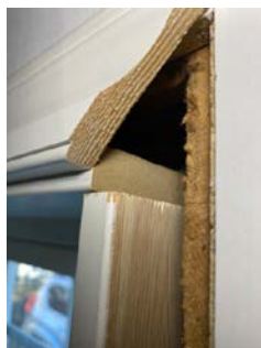
Manglende isolering/dampsperre rundt innforet vindu mot nord.
