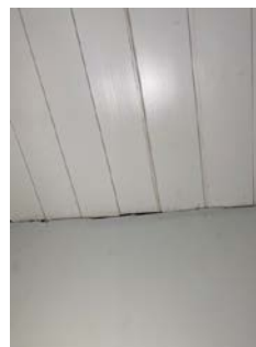
Rennemerker fra pipen og langs takpanel i loftsstuen.
