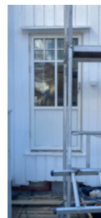
Balkongdør mot øst mangler utvendig trapp.
