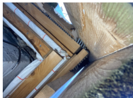
Tetting med musebånd må utbedres.
