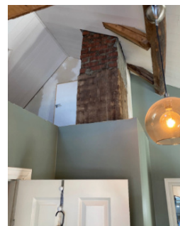
Deler av pipevanger er ikke synlige.
