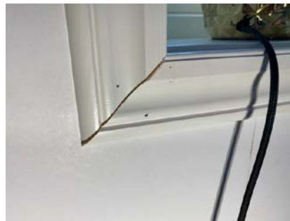
Glippe i sammenføring listverk rundt vindu
