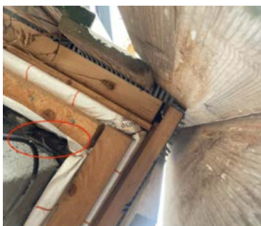
Bakforliggende kledning har tegn til råteskader. Manglende innfestning av kledning
