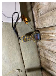
Fuktmåling mot panelet, skillevegg på bod.
