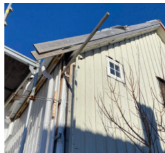
Manglende overflatebehandling av vindskier.
