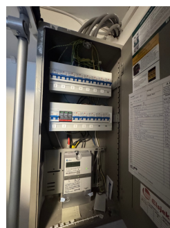
Sikringsskap med automatsikringer.
