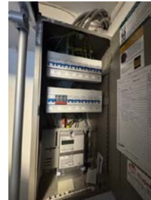
Sikringsskap med automatsikringer.
