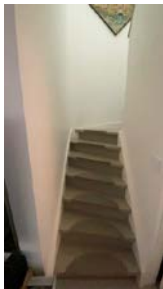
Det mangler håndløper på begge sider i trappen.
