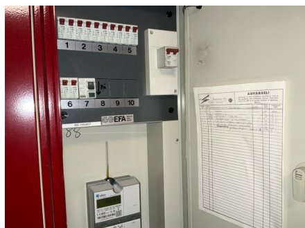
Automatsikringer i sikringsskap plassert i gang/fellesareal.
