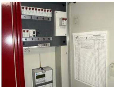
Automatsikringer i sikringsskap plassert i gang/fellesareal.
