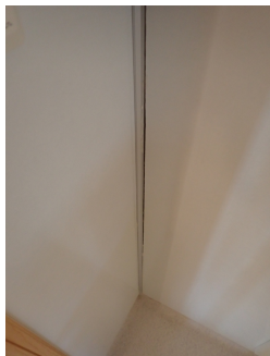
Sprekker mellom våtromsplater og innvendige hjørnelister.
