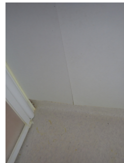
Fuktskader i nedre deler av våtromsplater i dusjsonen.
