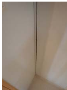
Sprekker mellom våtromsplater og innvendige hjørnelister.
