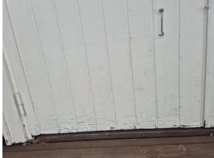
Værslitt balkongdør i 2. etg.
