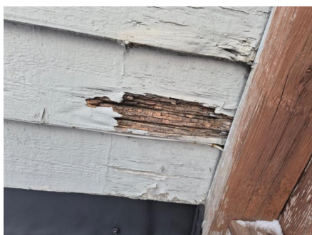
Store råteskader på vegger.
