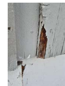
Råte i bunn av kledningsbord.
