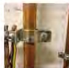
Eks. jording til vannrør (utjevningsforbindelse)
