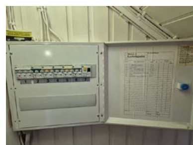
Sikringskap til loftetasje.
