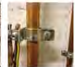
Eks. jording til vannrør (utjevningsforbindelse)
