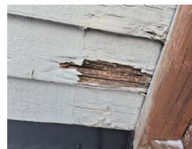
Store råteskader på vegger.
