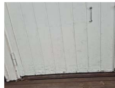
Værslitt balkongdør i 2. etg.
