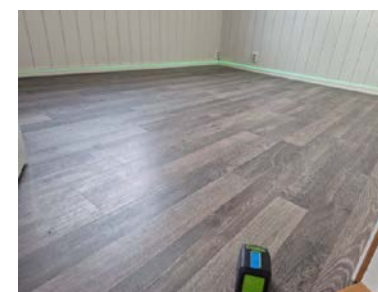
Skjevheter i gulv.
