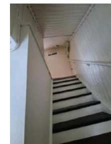
Mangler håndløper på en side
