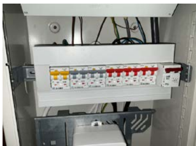
Utstyr for varsling og slukking av brann
