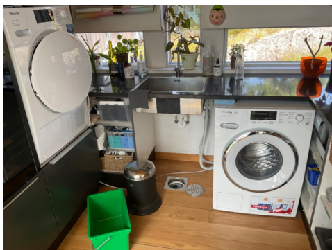
Vaskemaskin på grovkjøkken.
