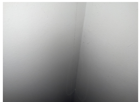
Sprekk i overflate ved toalett.
