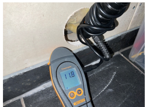
Hull tatt i teknisk rom.
