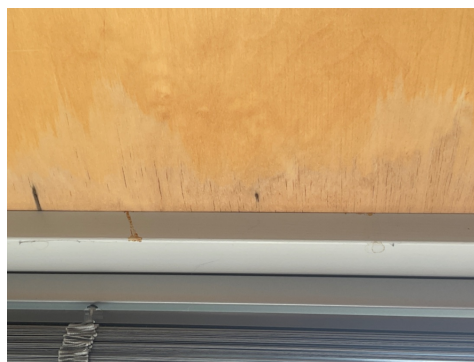
Fuktmerker i grovkjøkkenen.
