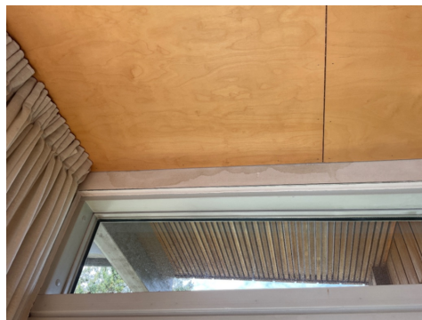
Fuktmerker i stue
