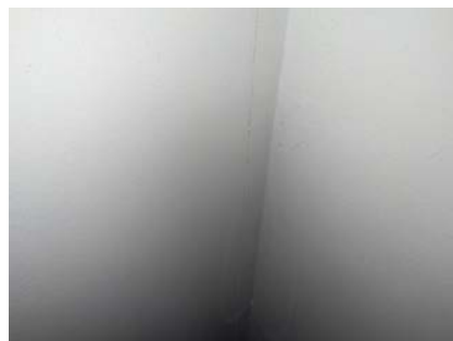
Sprekk i overflate ved toalett.
