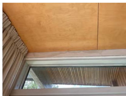
Fuktmerker i stue
