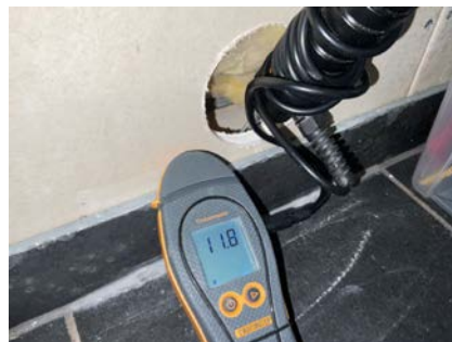
Hull tatt i teknisk rom.
