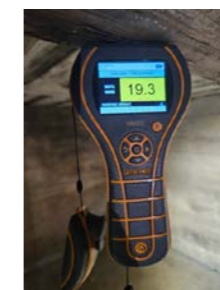
Måling av trefukt i etasjeskiller mot 1. et. Over anbefalte verdier men ikke kritisk.
