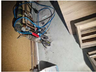
Ikke tilfredsstillende tettesjikt på gulv og vegg.
