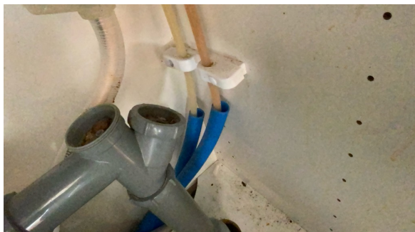
Vannrør i kjøkkenbenk.
