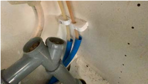
Vannrør i kjøkkenbenk.
