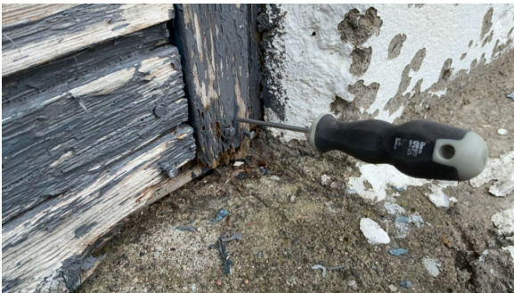
Råteskade på dør
