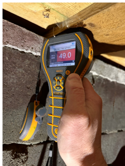
Synlig fukt på bjelken - høyt utslag ved måling
