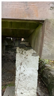
Bærebjelke ligger helt på kanten av søylepunkt
