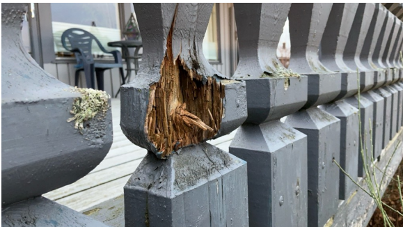
Råteskade på rekkverk
