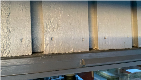
Det er registrert liten eller ingen klaring mellom beslag og trevirke.
