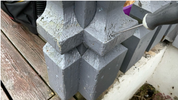
Noe råte i rekkverk
