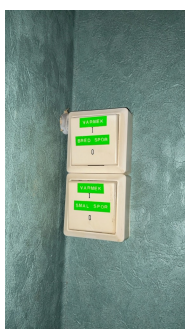
Bryter for varmekabler i utvendig vei/gangvei
