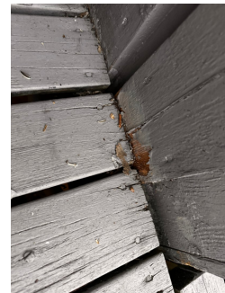
Det er ikke montert beslag mellom yttervegg og balkong/terrasse.
