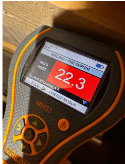
Høyt utslag ved måling på stubbloft (taket)
