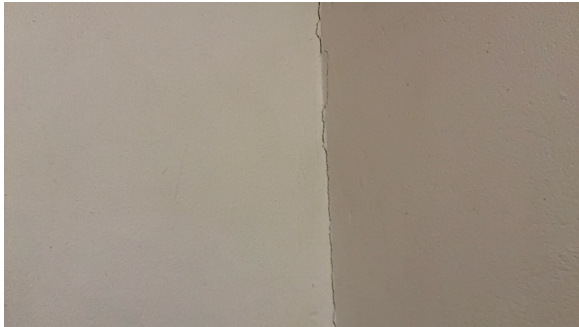
Riss/sprekk mellom brannmur og pipe
