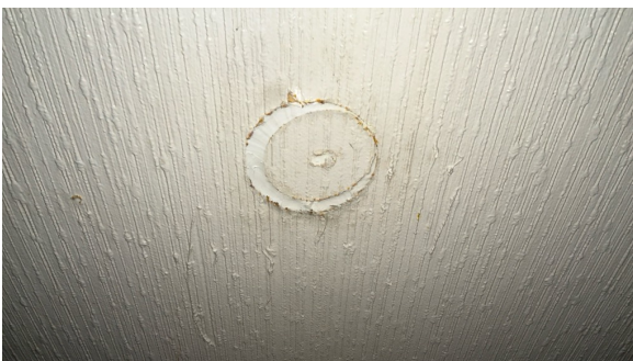
Tettet hull i stuevegg
