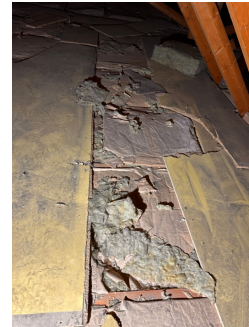
Papp over isolasjon som er skadet/mangelfull
