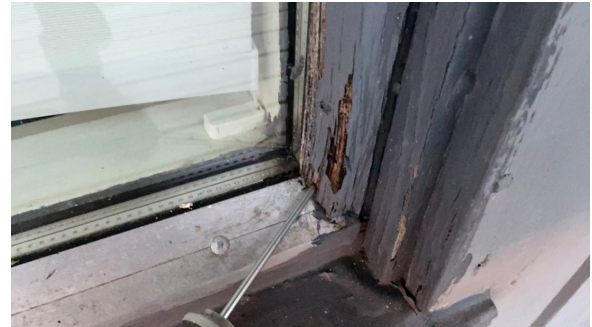
Råte i klemlist
