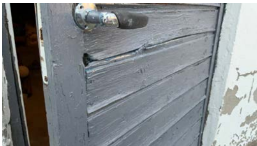
Døren er værslitt, med utvendig sprekker i trevirket.
