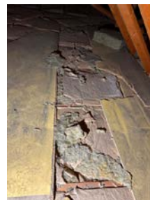
Papp over isolasjon som er skadet/mangelfull
