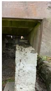
Bærebjelke ligger helt på kanten av søylepunkt
