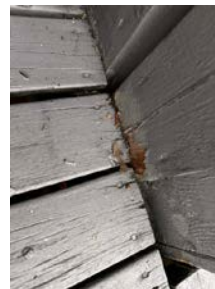
Det er ikke montert beslag mellom yttervegg og balkong/terrasse.
