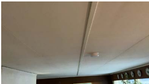
List over plateskjøt i stuetak.
