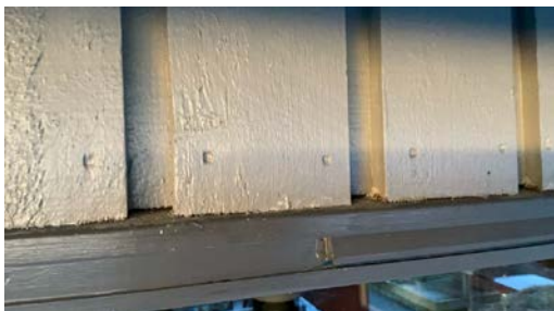
Det er registrert liten eller ingen klaring mellom beslag og trevirke.
