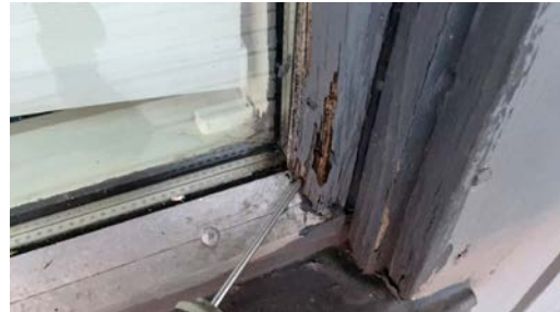
Råte i klemlist
