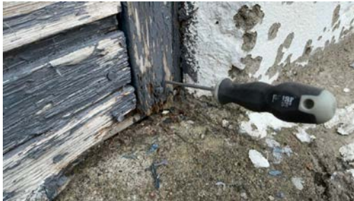
Råteskade på dør
