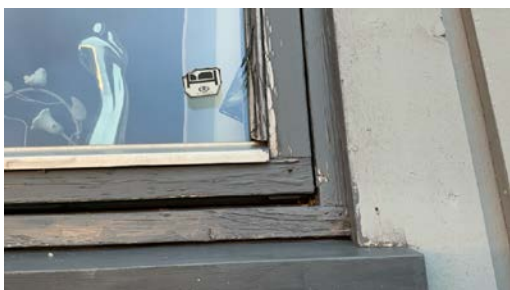
Karmene i vinduer er slitte og det er sprekker i trevirket. Det er registrert liten eller ingen klaring mellom beslag og trevirke.
