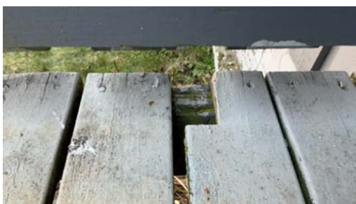
Det er registrert noen terrassebord uten full bredde i enden.
