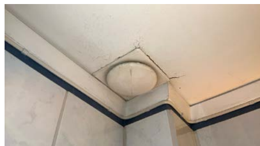
Takventil på wc
