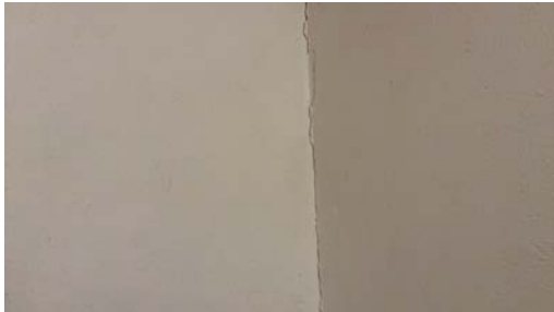
Riss/sprekk mellom brannmur og pipe
