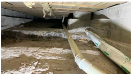
Manglende klamring av avløpsrør
