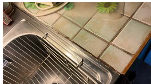
Det er registrert manglende eller oppsprukket fugemasse/silikon mellom benkeplate og vask.
