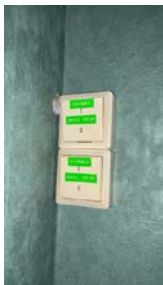
Bryter for varmekabler i utvendig vei/gangvei
