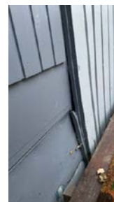
Noe skjevheter i vegger, ref eget punkt om veggkonstruksjonen
