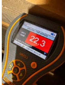
Høyt utslag ved måling på stubbloft (taket)
