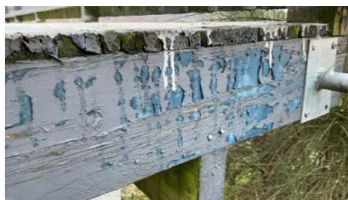
Det er registrert slitasje
