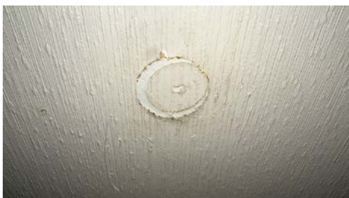
Tettet hull i stuevegg
