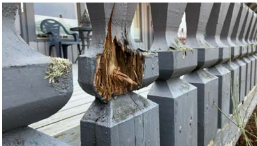
Råteskade på rekkverk
