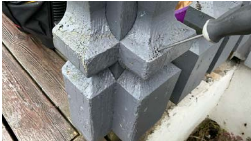
Noe råte i rekkverk
