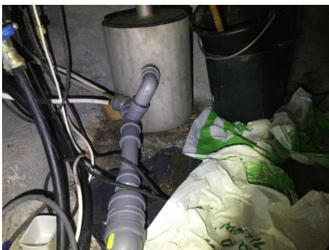
Rør/stoppekran, tilgjengelig via luke i stue.
