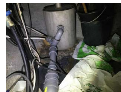
Rør/stoppekran, tilgjengelig via luke i stue.
