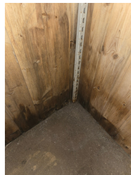
Synlig råteskader i trevirke kjeller
