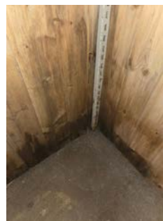
Synlig råteskader i trevirke kjeller
