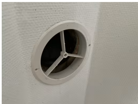
Foto viser avløpsrør av plast, eier har benyttet skru ventil som tildekning.
