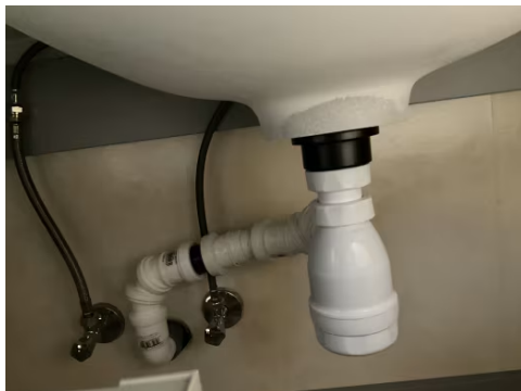
Foto viser manglende tetting rundt avløp vask.
