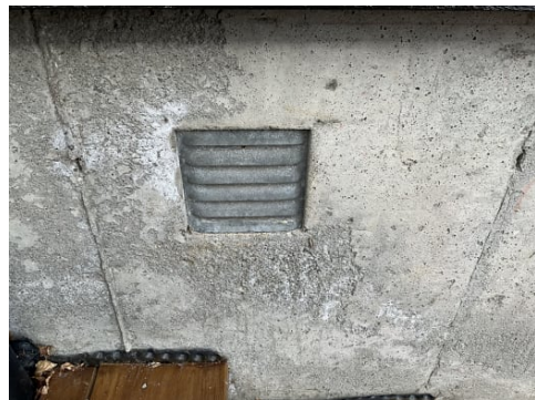
Foto viser avskalling rundt ventiller også observert stedvis på grunnmur. Stag som er ført gjennom grunnmuren er ikke innpusset.
