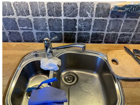
Foto viser at funksjonstest av stoppekran fungerer som tiltenkt.
