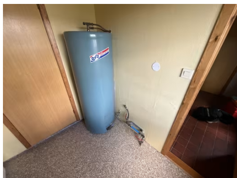
Foto viser varmtvannsbereider og stoppekraner.
