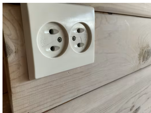
Foto viser sprekk i stikk.
