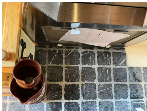
Foto viser mekanisk avtrekk, vifte vurderes å fungere ved test. Defekte lyst.
