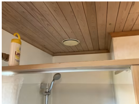
Foto viser naturlig ventilasjon i tak.
