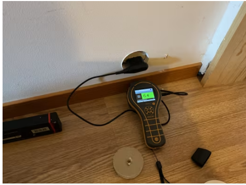
Fuktmåling i lukket veggkonstruksjon bak dusj, 6,4 vekt% på befaringdagen.
