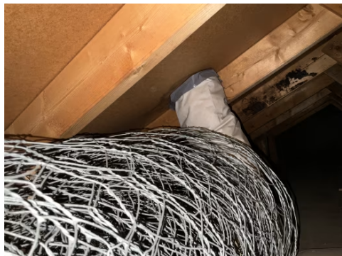
Foto viser eksempel på fuktmerker rundt takgjennomføringer.
