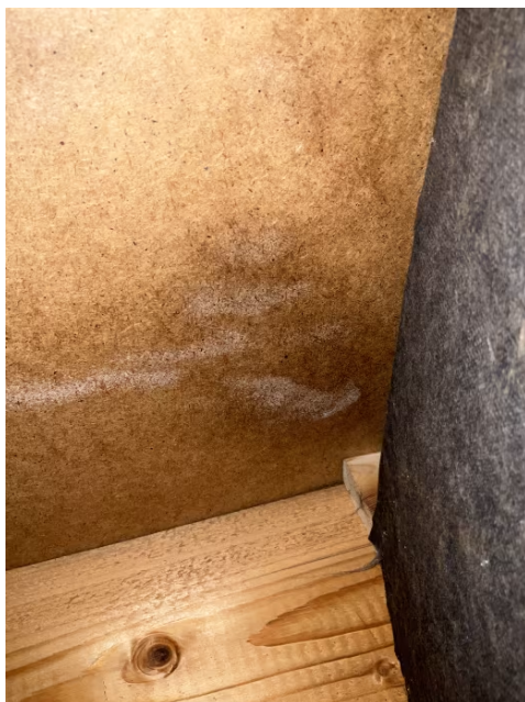
Foto viser eksempel på fuktmerker i undertaket.
