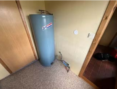
Foto viser varmtvannsbereider og stoppekraner.
