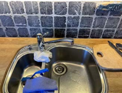
Foto viser at funksjonstest av stoppekran fungerer som tiltenkt.
