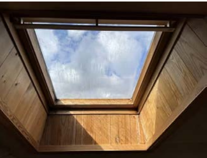
Foto viser eksempel på punktert glass og fuktskader/ merker i karm/ ramme.
