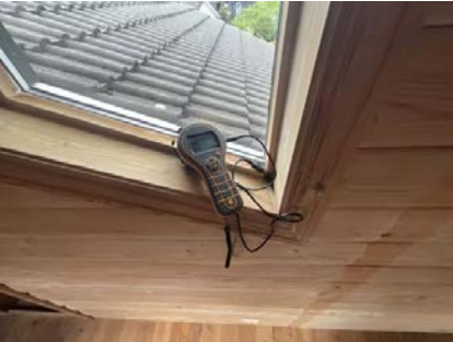
Foto viser eksempel på funksjonstest og fuktmåling i fuktmerker. På befaringsdagen ble det registrert verdier under grenseverdi for råte, tilstand i karm/ ramme tilsier likevel at vinduer og dører bør byttes.
