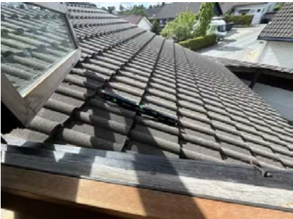
Foto viser mindre mose på taket, kontroll indikerer ca 23 grader fall på taktekkingen, relativt ru takstein medfører vurdering om at det ikke er krav til snøfanger.
