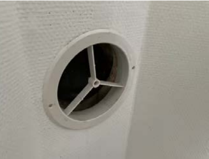
Foto viser avløpsrør av plast, eier har benyttet skru ventil som tildekning.
