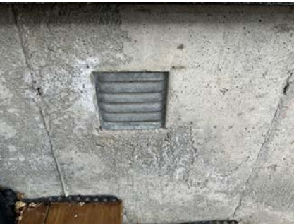
Foto viser avskalling rundt ventiller også observert stedvis på grunnmur. Stag som er ført gjennom grunnmuren er ikke innpusset.
