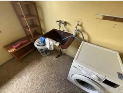
Fuktskader på vegg, utett belegg på gulv. Skjulte feil og mangler kan ikke utelukkes.
