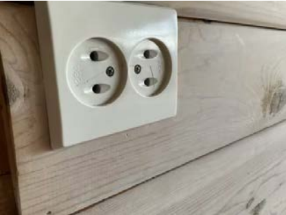
Foto viser sprekk i stikk.
