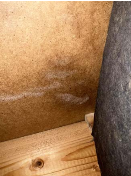
Foto viser eksempel på fuktmerker i undertaket.
