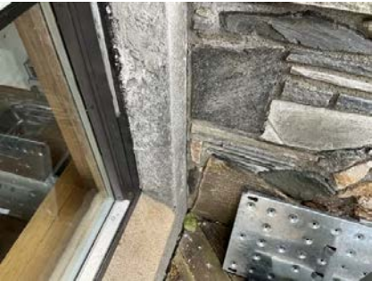
Rundt vinduer i kjeller er avskalling i grunnmuren påvist.
