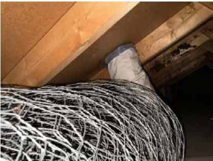
Foto viser eksempel på fuktmerker rundt takgjennomføringer.
