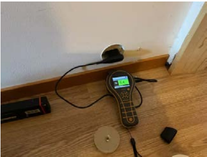
Fuktmåling i lukket veggkonstruksjon bak dusj, 6,4 vekt% på befaringsdagen.
