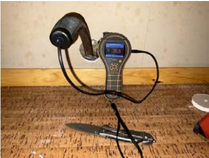
Foto viser fuktmåling i lukket konstruksjon, på befaringsdagen ca 36,5 vekt%, dette er over grenseverdien for når råte kan oppstå i lukket konstruksjon.
