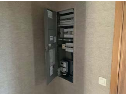
Foto viser sikringsskapet på befaringsdagen.
