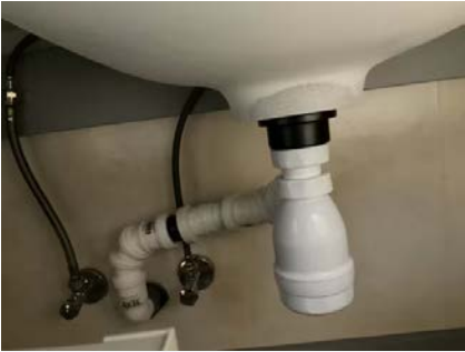
Foto viser manglende tetting rundt avløp vask.
