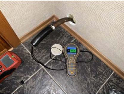
Foto viser fuktmåling i lukket konstruksjon bak badekar. Vurderes tørt på befaringsdagen.
