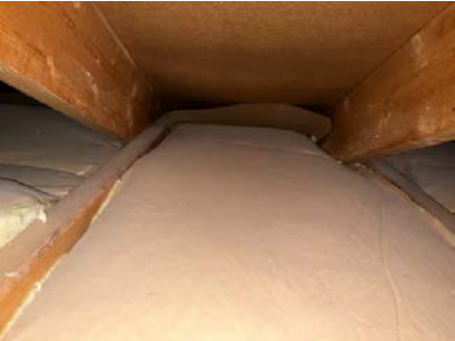
Innvendig i kott er luftespalter i raft redusert. Kan ikke utelukkes skjulte skader i takkonstruksjon som ikke er synlig.
