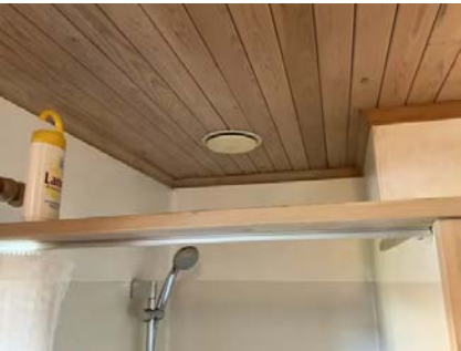
Foto viser naturlig ventilasjon i tak.
