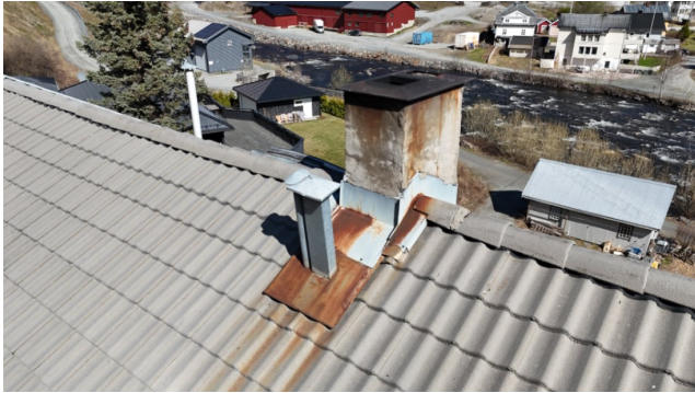
Rustdannelse i beslag til lufterør.
