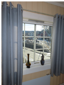
Spalteventiler i øvre vinduskarm.
