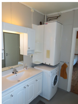
Del av bad/vaskerom. Vegghengt varmtvannsbereder.
