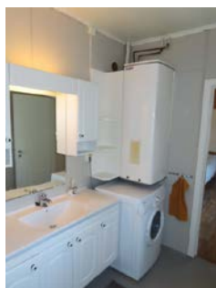
Del av bad/vaskerom. Vegghegt varmtvannsbereider.
