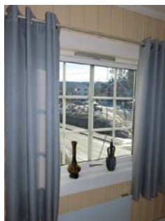
Spalteventiler i øvre vinduskarm.
