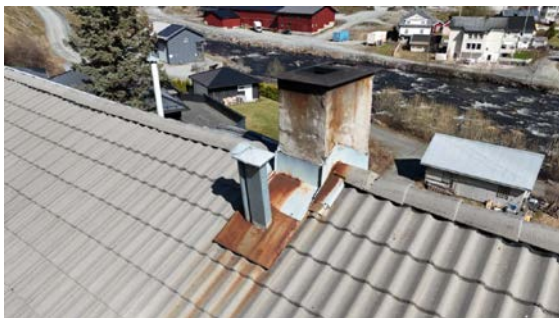
Rustdannelse i beslag til lufterør.
