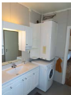
Del av bad/vaskerom. Vegghengt varmtvannsbereider.
