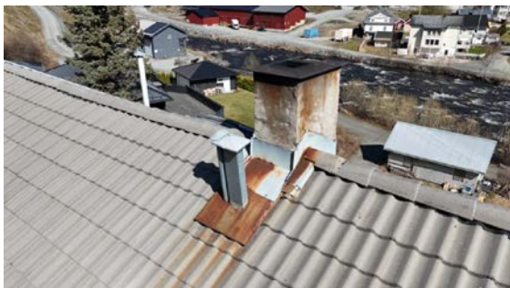
Rustdannelse i beslag til lufterør.
