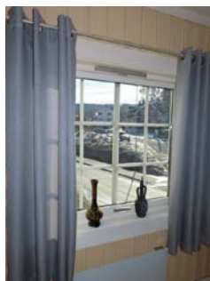
Spalteventiler i øvre vinduskarm.
