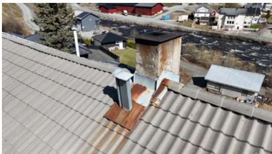
Rustdannelse i beslag til lufterør.
