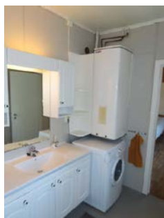
Del av bad/vaskerom. Vegghengt varmtvannsbereider.
