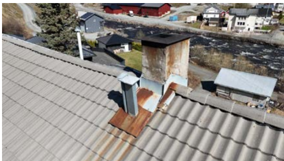
Rustdannelse i beslag til lufterør.
