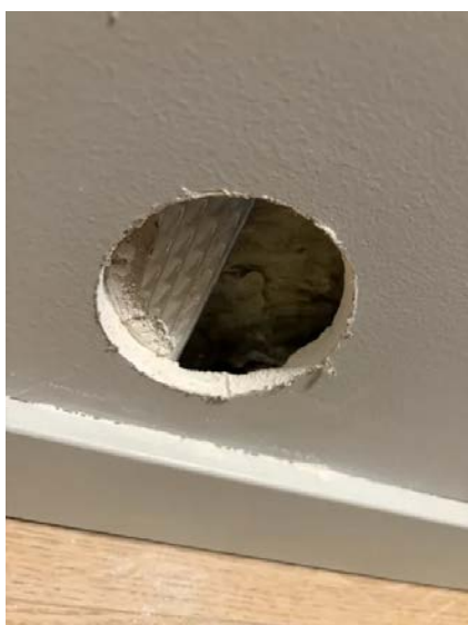
Kontrollen ble noe begrenset grunnet bruk av stålsvill/ stender. Undersøkelsen viser ingen tegn til skader eller fukt i konstruksjonen.
