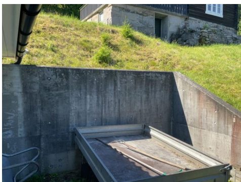
Forstøtningsmur uten fallsikring - rekkverk.
