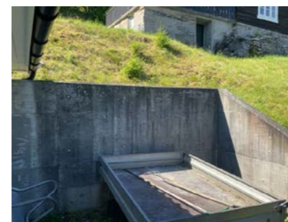
Forstøtningsmur uten fallsikring - rekkverk.
