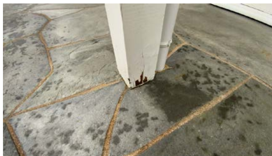
Noe råteskader på bærende søyler.
