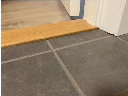
Ingen oppbrett av membran ved terskel.
