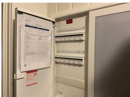
Sikringsskap plassert på bod.
