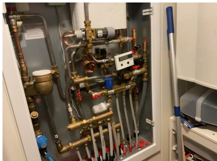
Fordelingskap plassert på bod.
