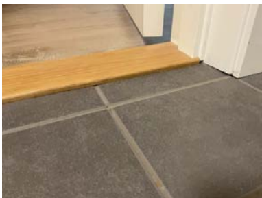
Ingen oppbrett av membran ved terskel.
