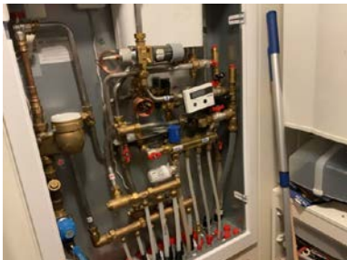
Fordelingsskap plassert på bod.
