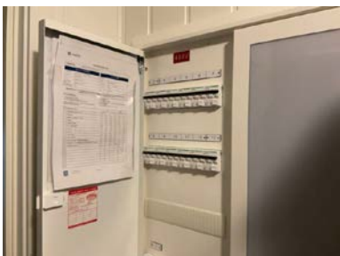
Sikringsskap plassert på bod.
