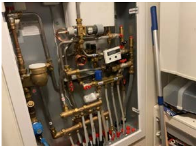
Fordelingsskap plassert på bod.
