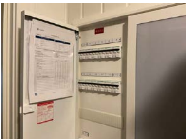
Sikringsskap plassert på bod.
