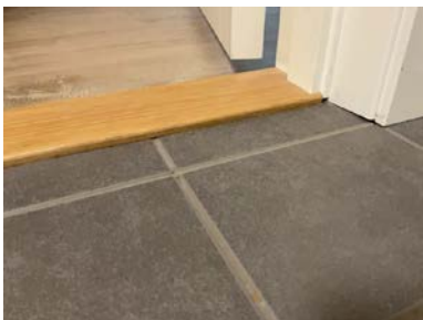
Ingen oppbrett av membran ved terskel.
