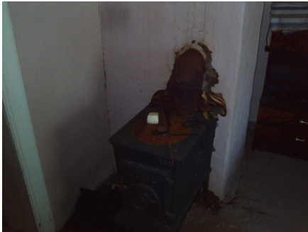
Eldre vedovn med rust.
