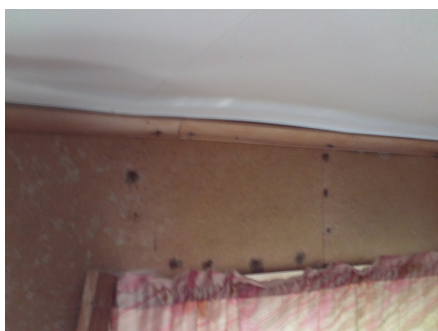
Kondens/fuktskader i trapperommet.
