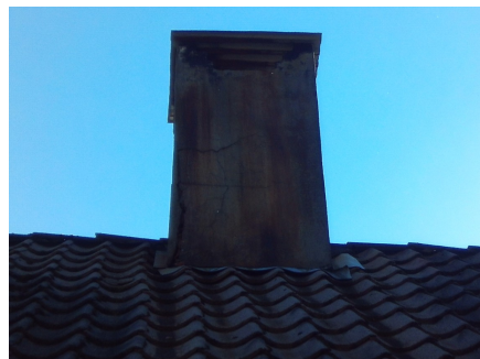
Større lekkasje i rundt pipe.
