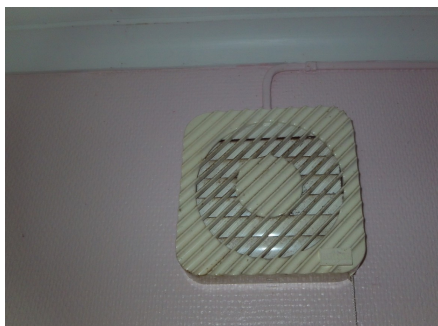
Vifte i ytterveggen.
