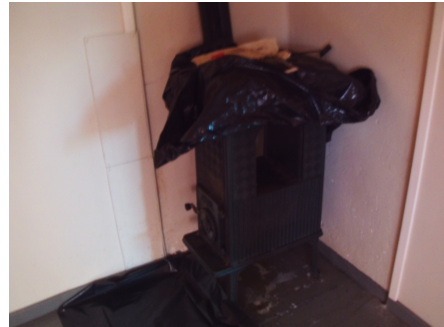
Vedovn i ene stuen. (lekkasje i himling)
