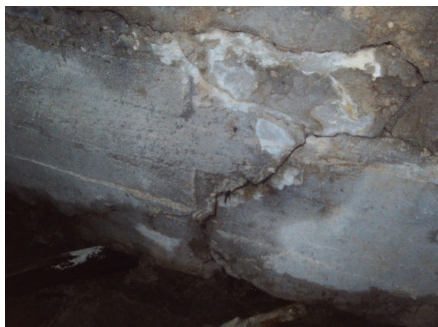
Sprekk i grovkjeller
