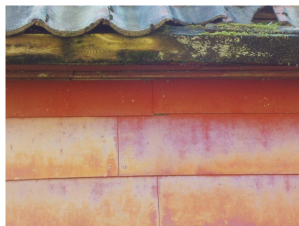
Takrenner mangler og dermed skader.
