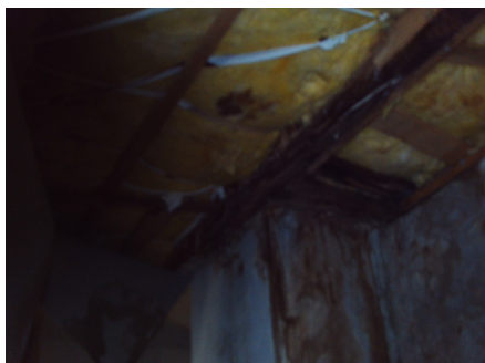
Skader i rundt pipe.
