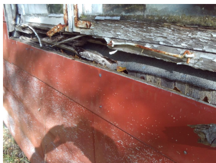
Vannbord er borte under vinduer.
