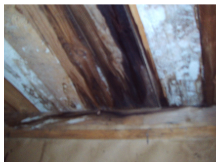
Fukt/råteskader i rundt pipe.
