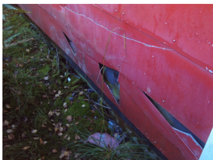
Skader på fasadeplater.
