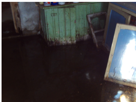
Større mengder vann på gulvet på befaringen.
