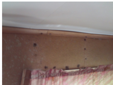
Veggplater har svellet og stifter rustet.
