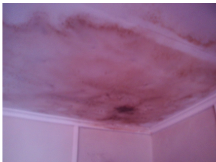
Lekkasjeskader i rundt pipe i stue
