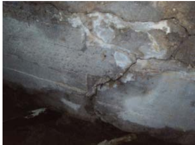
Sprekk i grovkjeller
