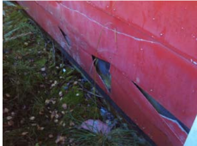
Skader på fasadeplater.
