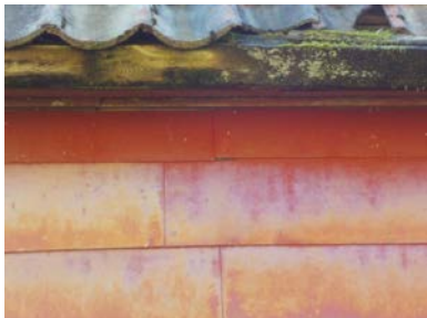
Takrenner mangler og dermed skader.
