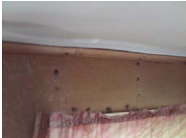
Veggplater har svellet og stifter rustet.
