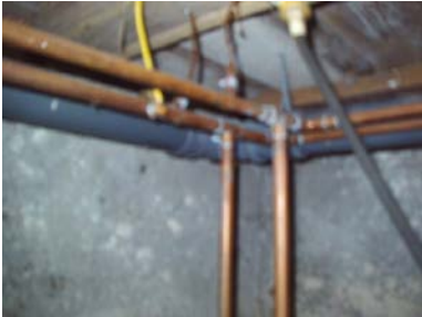
Deler av røropplegget i grovkjeller.
