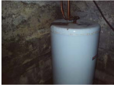
Eldre bereder er plassert i grovkjeller.
