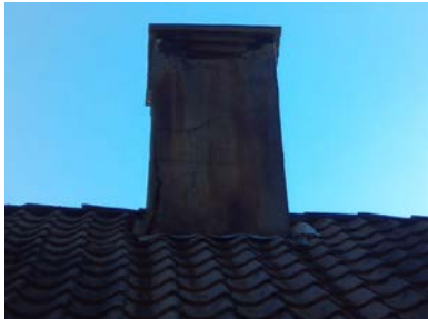
Større lekkasje i rundt pipe.
