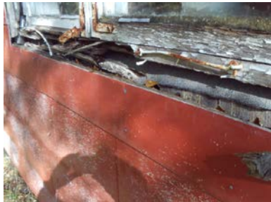
Vannbord er borte under vinduer.
