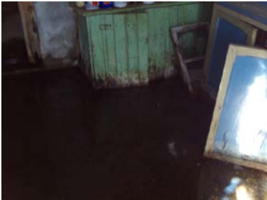
Større mengder vann på gulvet på befaringen.
