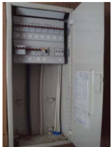
Sikringsskapet er plassert i trappegangen i tilbygget
