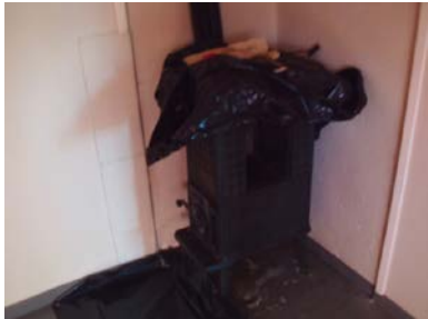
Vedovn i ene stuen. (lekkasje i himling)
