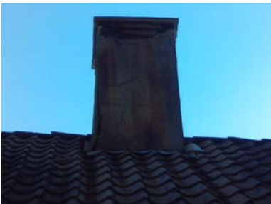
Lekker i rundt pipe.
