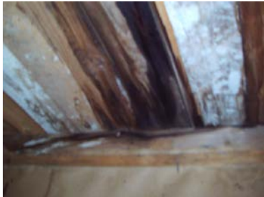
Fukt/råteskader i rundt pipe.
