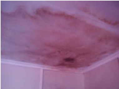
Lekkasjeskader i rundt pipe i stue
