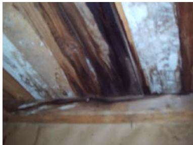
Fukt/råteskader i rundt pipe.
