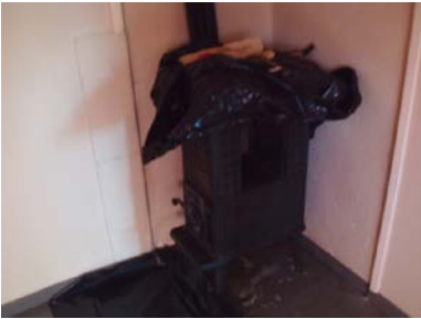
Vedovn i ene stuen. (lekkasje i himling)
