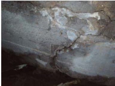
Sprekk i grunnmur i bakre del av grovkjeller.
