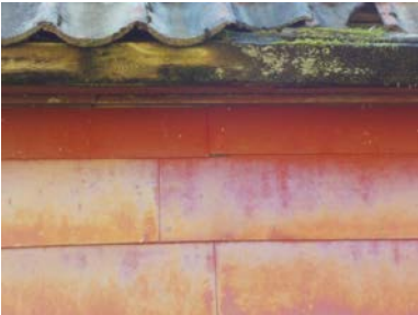
Takrenner mangler og dermed skader.
