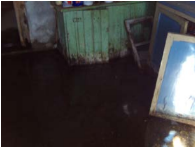
Større mengder vann på gulvet på befaringen.
