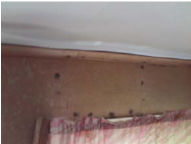
Kondens/fuktskader i trapperommet.
