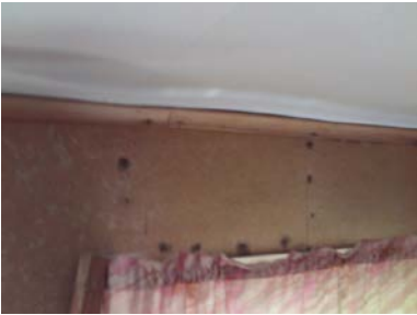
Veggplater har svellet og stifter rustet.
