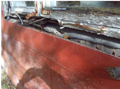
Vannbord er borte under vinduer.
