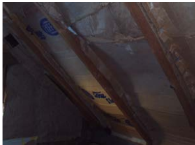
Deler isolert uten lufting i mellom undertak og isolasjon
