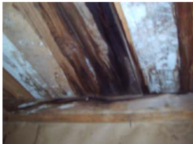
Fukt/råteskader i rundt pipe.
