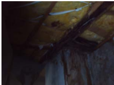
Skader i rundt pipe.
