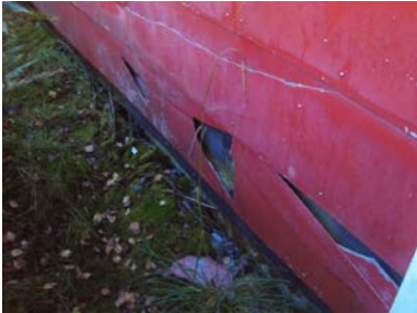
Skader på fasadeplater.
