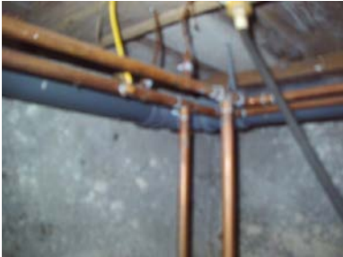
Deler av røropplegget i grovkjeller.
