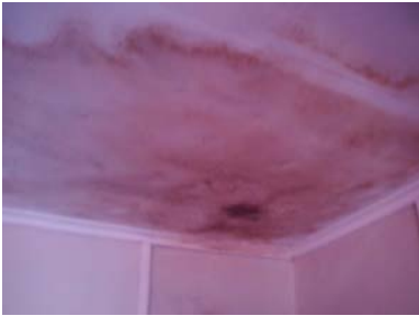
Lekkasjeskader i rundt pipe i stue
