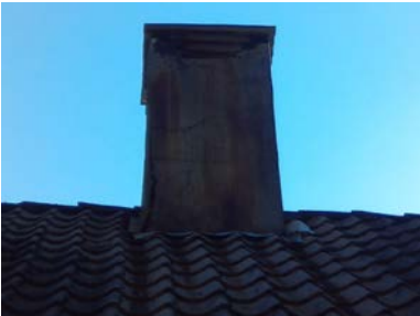
Større lekkasje i rundt pipe.
